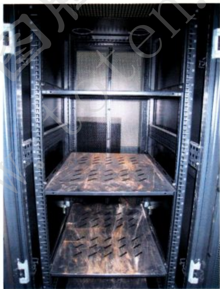
图4 网络机柜内部
